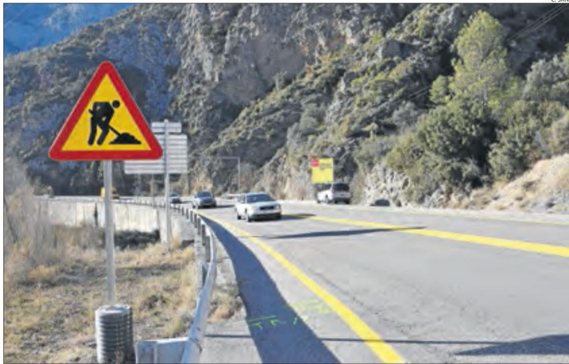
Senyalització d'obres al tram de la C-14 on es construirà el túnel de Tres Ponts.
