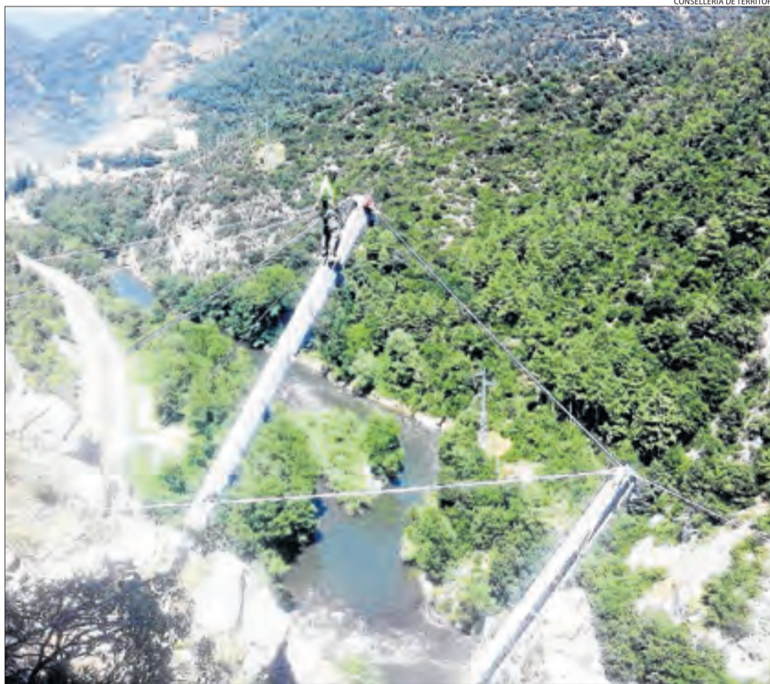
Un operari instal·lant pantalles per evitar la caiguda de roques a la C-14 el mes de juliol passat.
