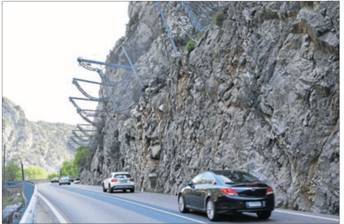
Xarxes per evitar la caiguda de roques instal·lades a la C-14 entre Organyà i Montant de Tost.
