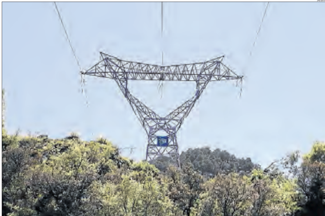
Línies d'alta tensió del Pirineu inclouen cables de fibra òptica per donar connexió a les hidroelèctriques.
