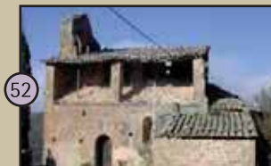
52 Sant Sebastià de la Clua Documentada des de 1091, l'església encapçala la població encimbellada de la Clua. Conserva dos sarcòfags medievals a la part del cementiri.
